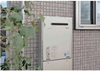
①ガス給湯器
